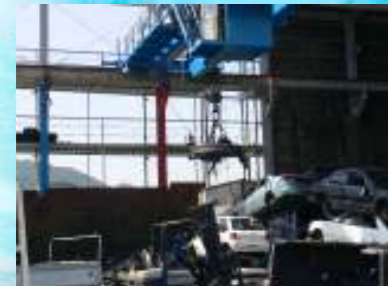
1800Φリフマグ及び10t天井クレーン
